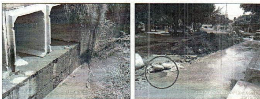
Imagen 7. Vertimiento de agua residual sobre el Colector Pluvial durante la mañana y la tarde del 20 de octubre de 2021.
