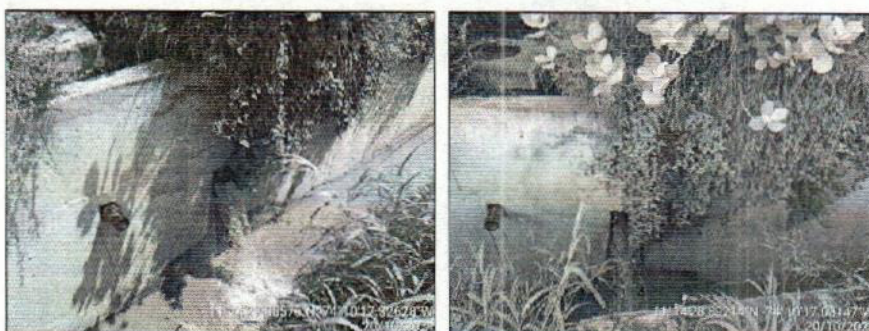
Imagen 6. Vertimiento de agua residual sobre el Colector Pluvial durante la mañana y la tarde del 20 de octubre de 2021.
