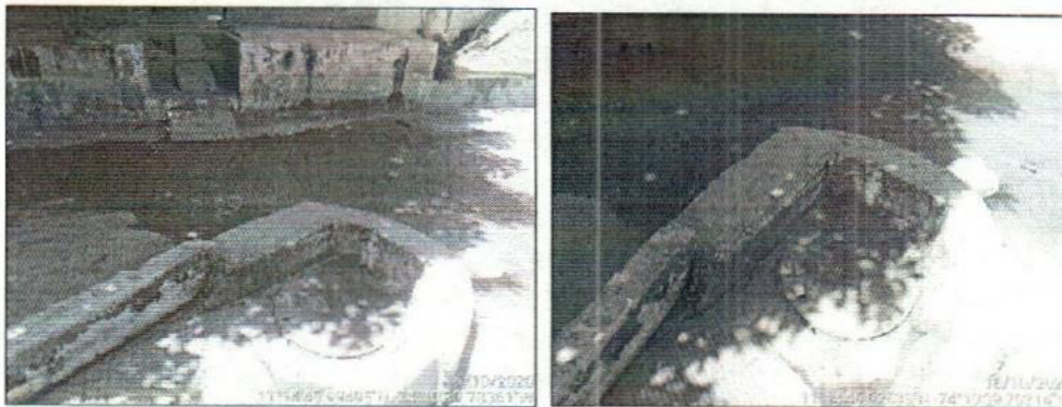
Imagen 4. Ausencia de rebosamiento en el manhole de la carrera 33 con calle 9B esquina durante el seguimiento realizado el 16 de octubre de 2020.
